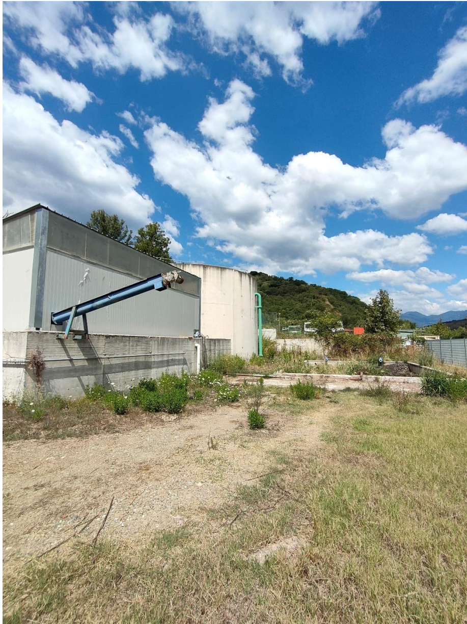
Figura 19: 1 – Coclea fanghi disidratati e letti di essiccamento
