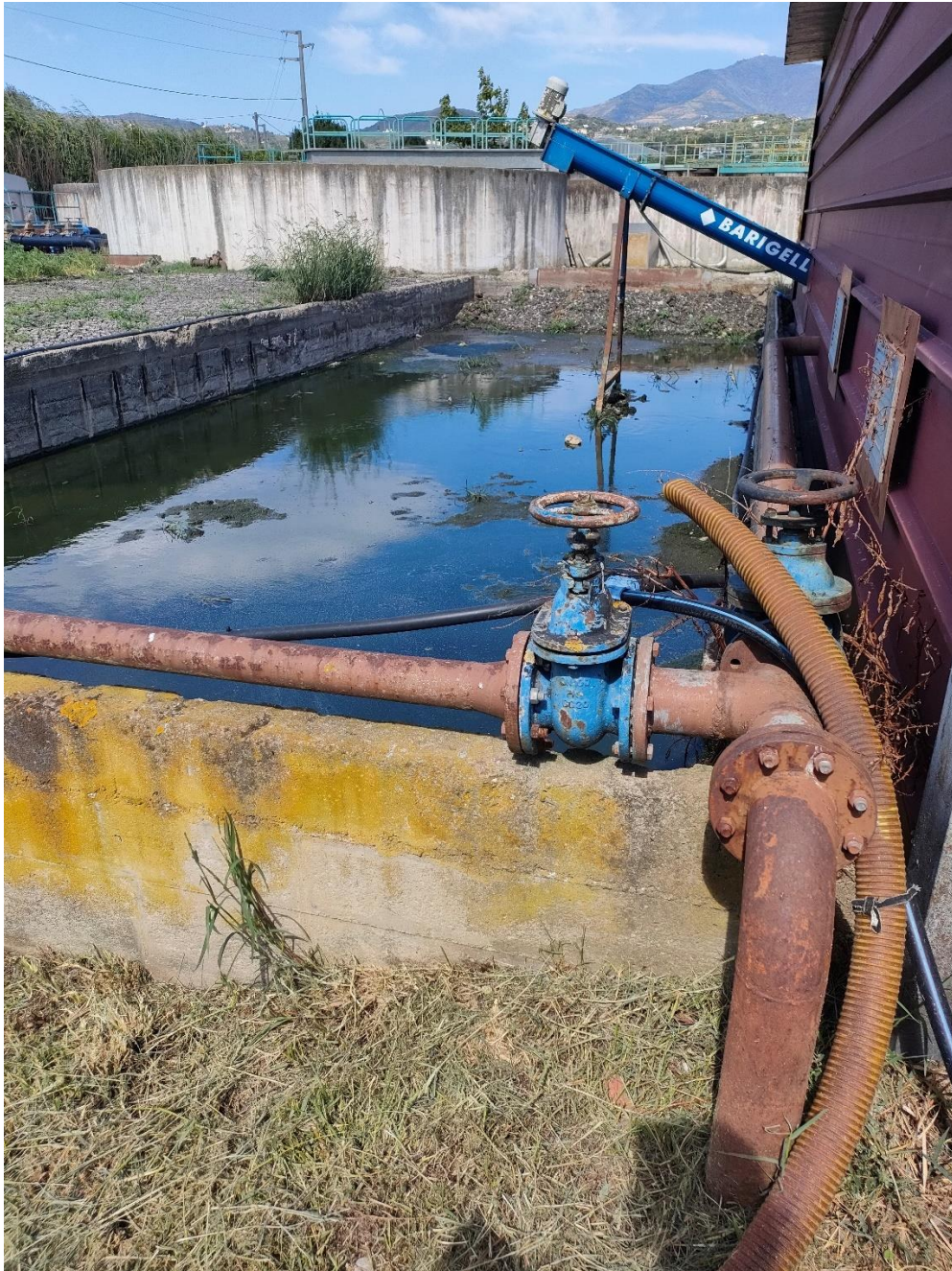
Figura 44: 3 – Letti di essiccamento e mandata da digestione aerobica
