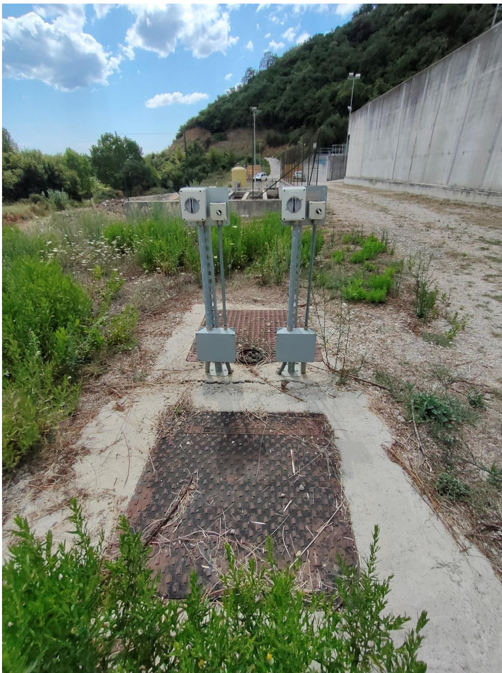
Figura 25: 7 – Pozzetto raccolta e sollevamento dreni
