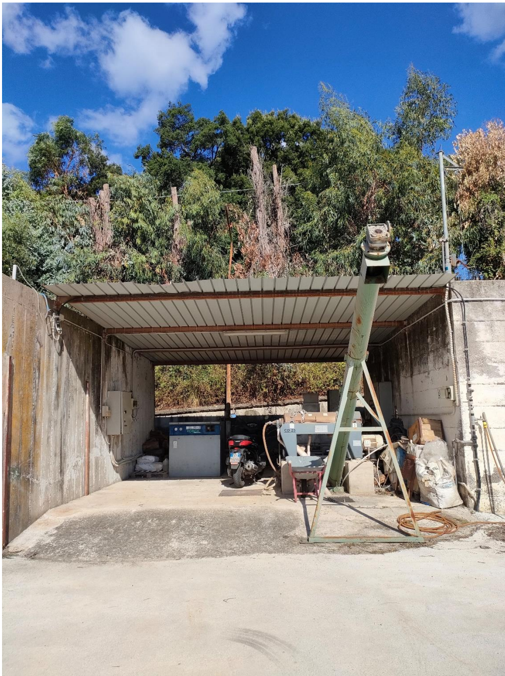
Figura 10: 3 – Tettoia disidratazione fanghi
