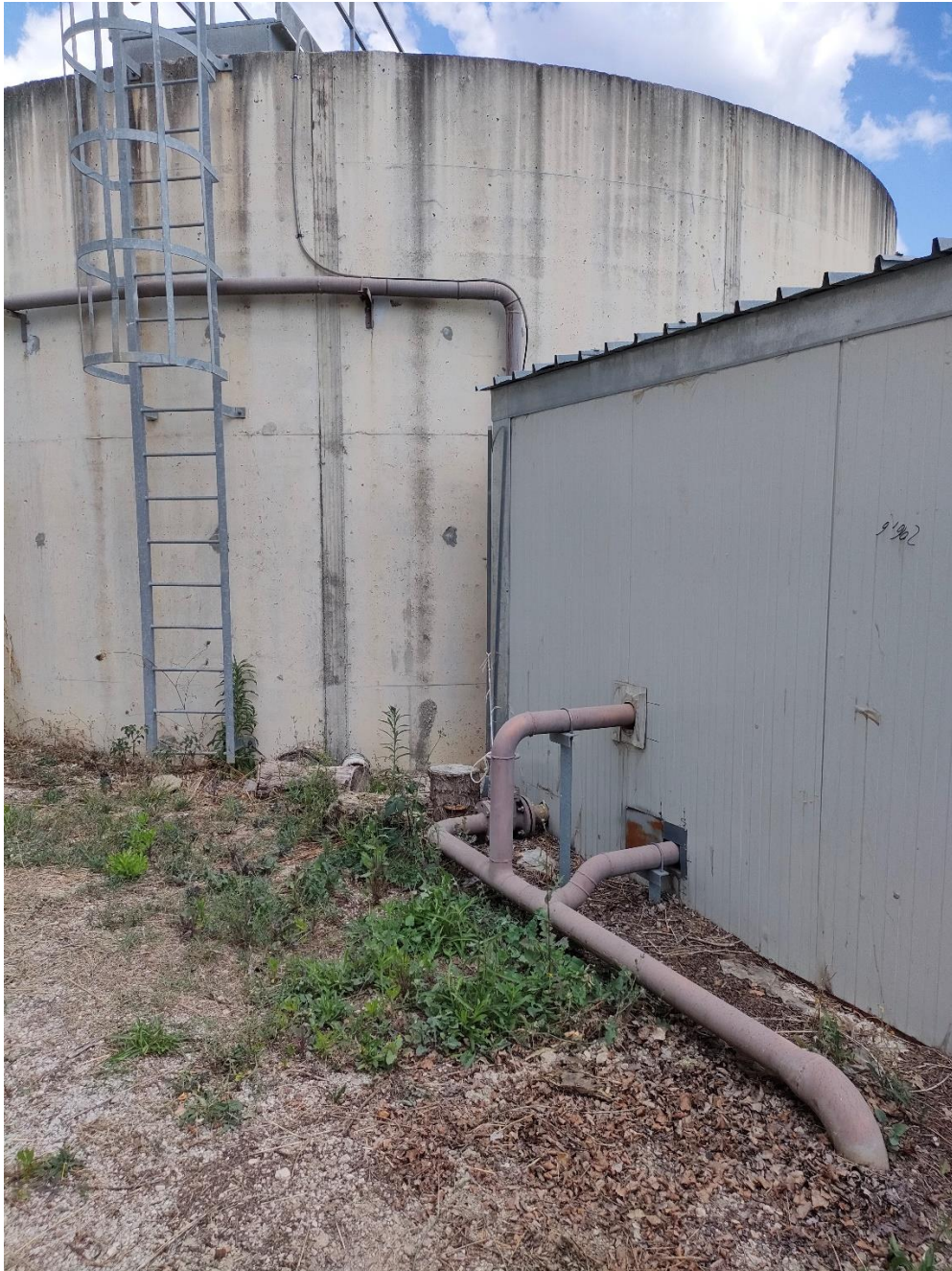
Figura 21: 3 – Spesitore statico e mandate a locale disidratazione (dismesso)
