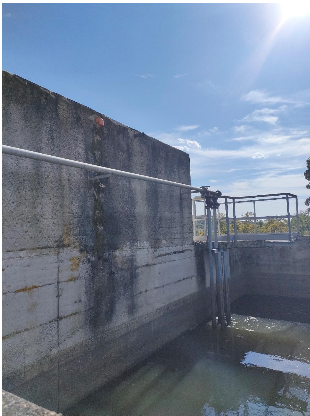
Figura 2: 1 – Sollevamento digestione aerobica
