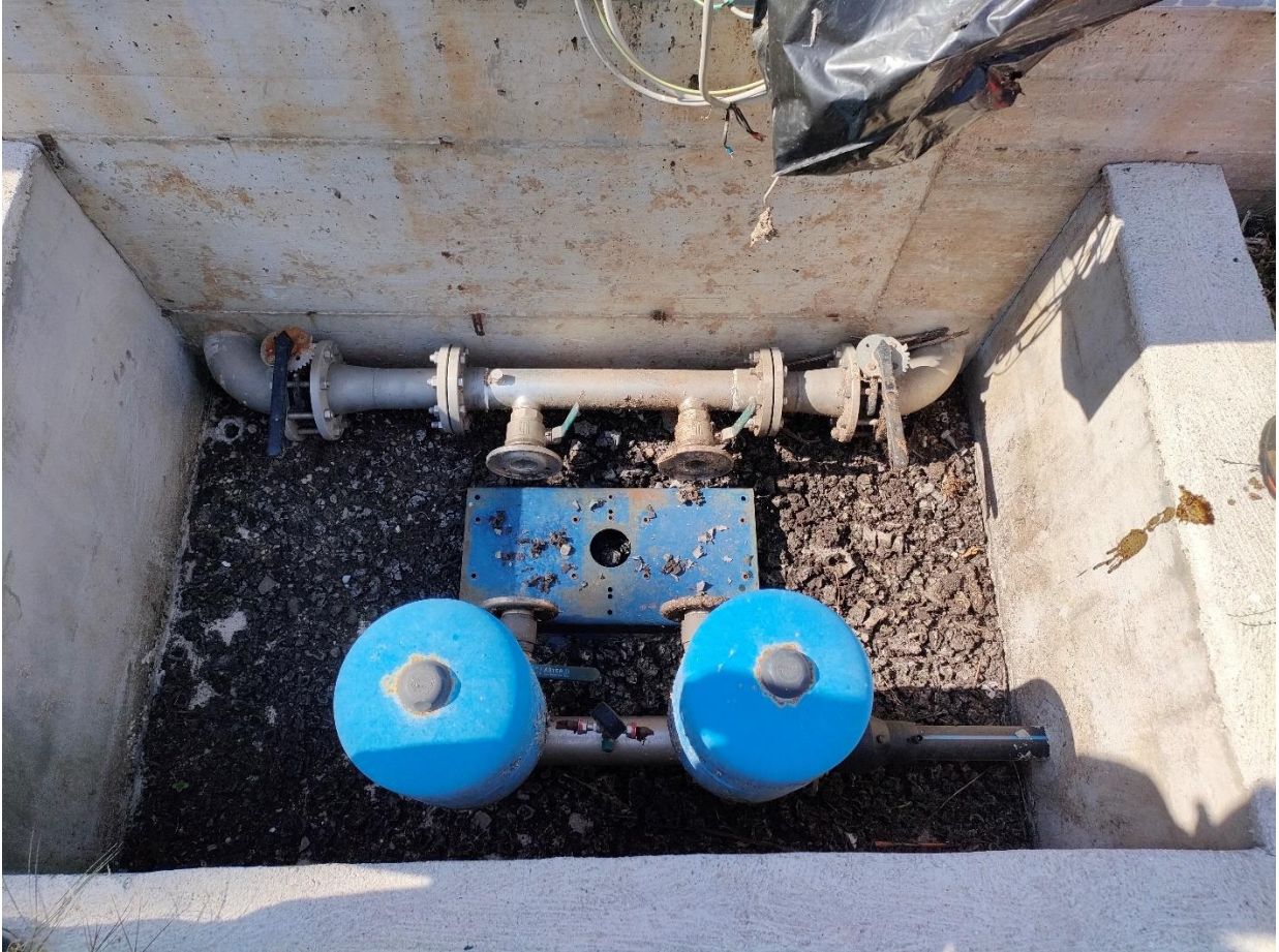
Figura 28: 1 – Predisposizione gruppo di pressurizzazione
