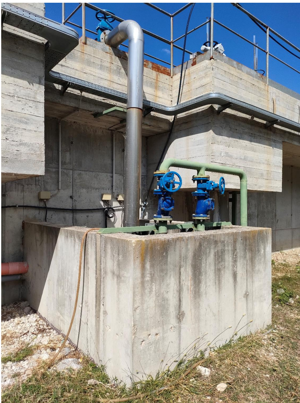
Figura 17: 4 – Pozzetto fanghi di supero
