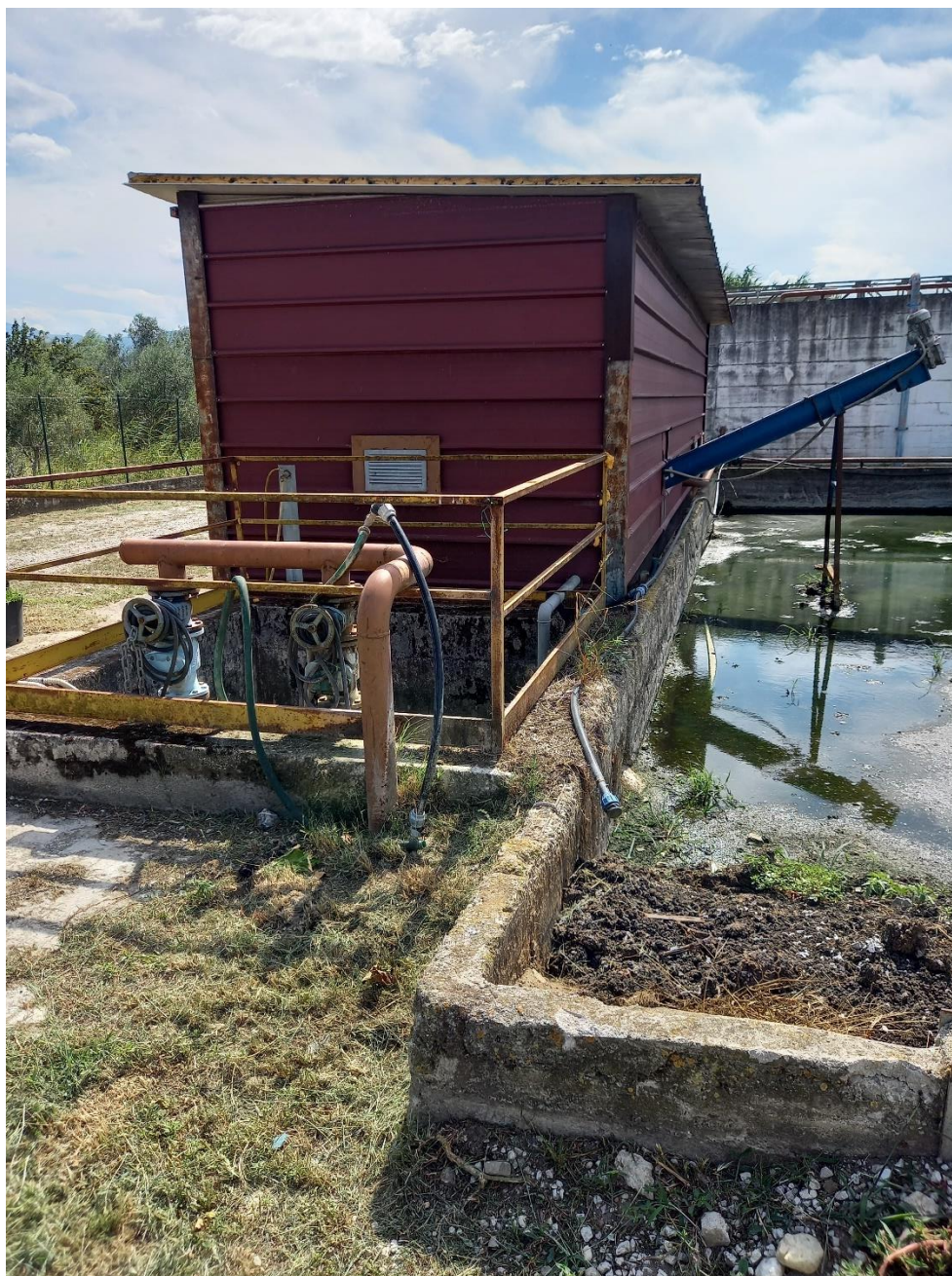
Figura 42: 1 - Letto di essiccamento e pozzetto accumulo e rilancio dreni
