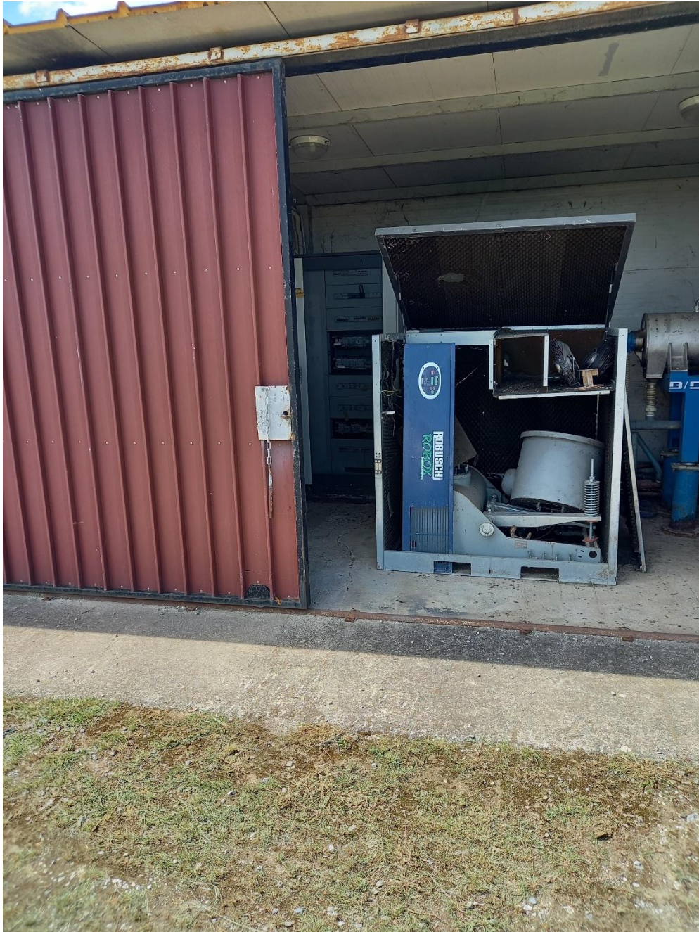
Figura 43: 2 – Locale disidratazione e soffiante dismessa
