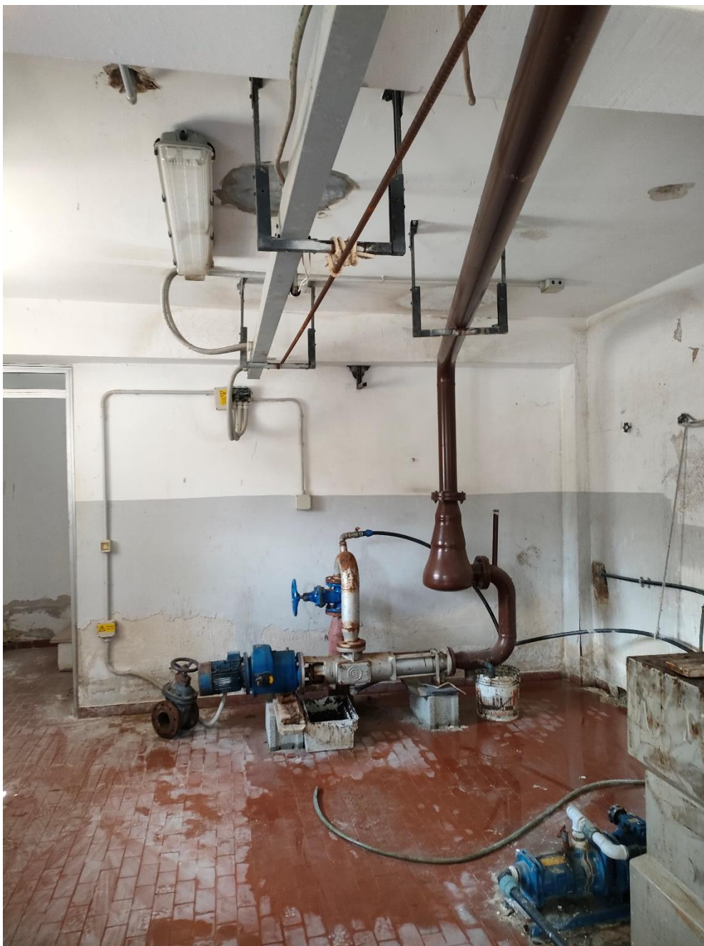
Figura 50: 1 – Piano terra - Pompa alimentazione fanghi a centrifuga
