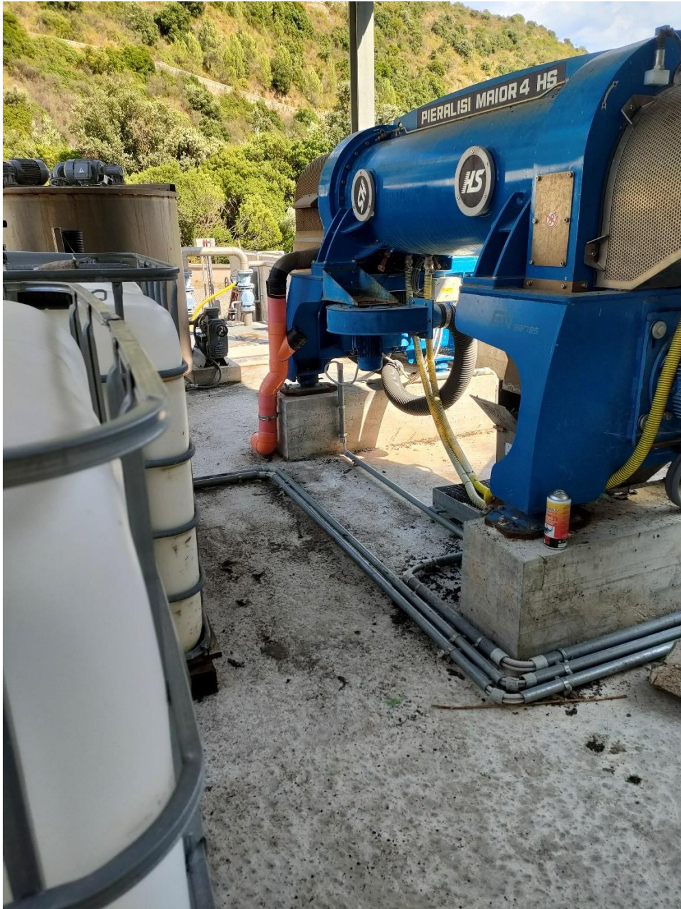
Figura 29: 2 – Centrifuga per disidratazione fanghi
