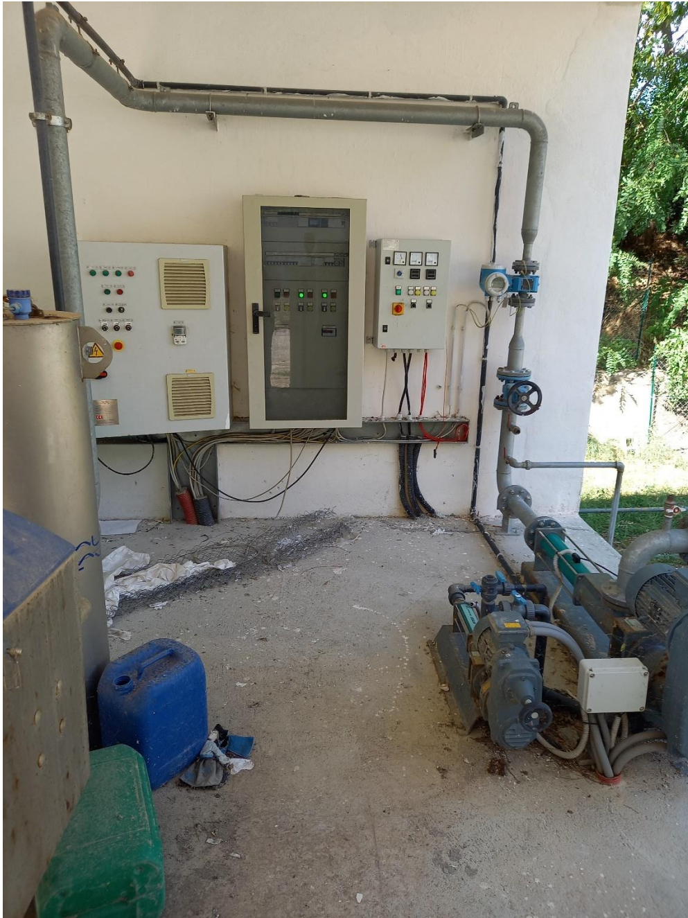
Figura 40: 6 – Quadri elettrici disidratazione
