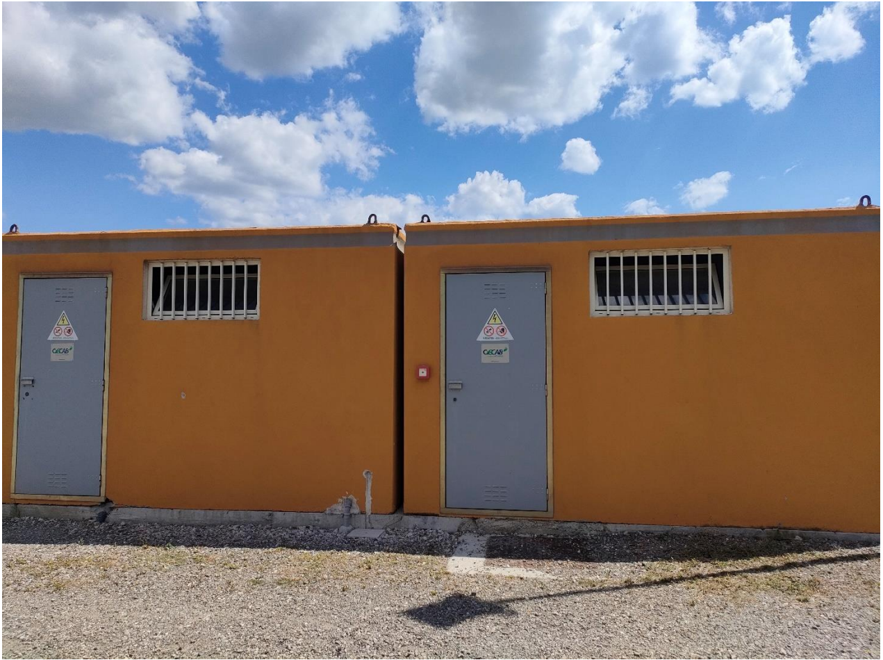
Figura 24: 6 – Locali quadri elettrici
