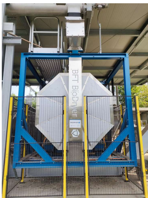
Figura 11: Protezione con rete in acciaio
