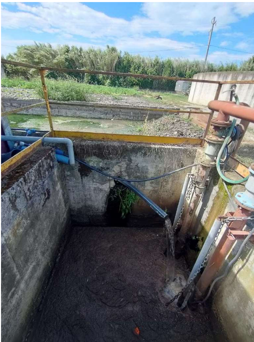
Figura 45: 4 – Pozzetto di accumulo e rilancio dreni
