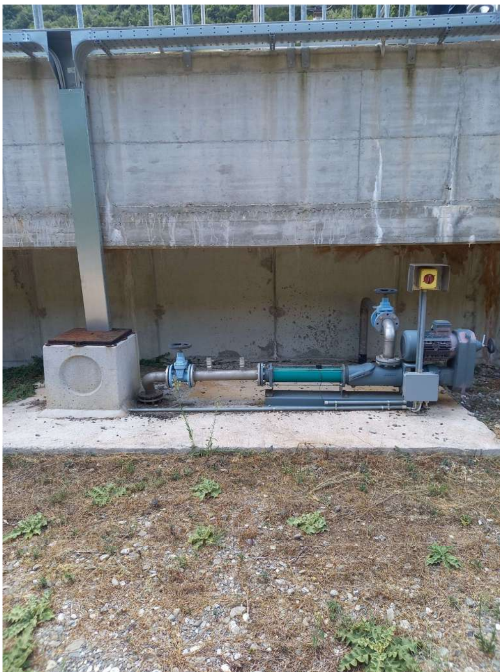
Figura 30: 3 – Pompa di alimentazione fanghi alla centrifuga
