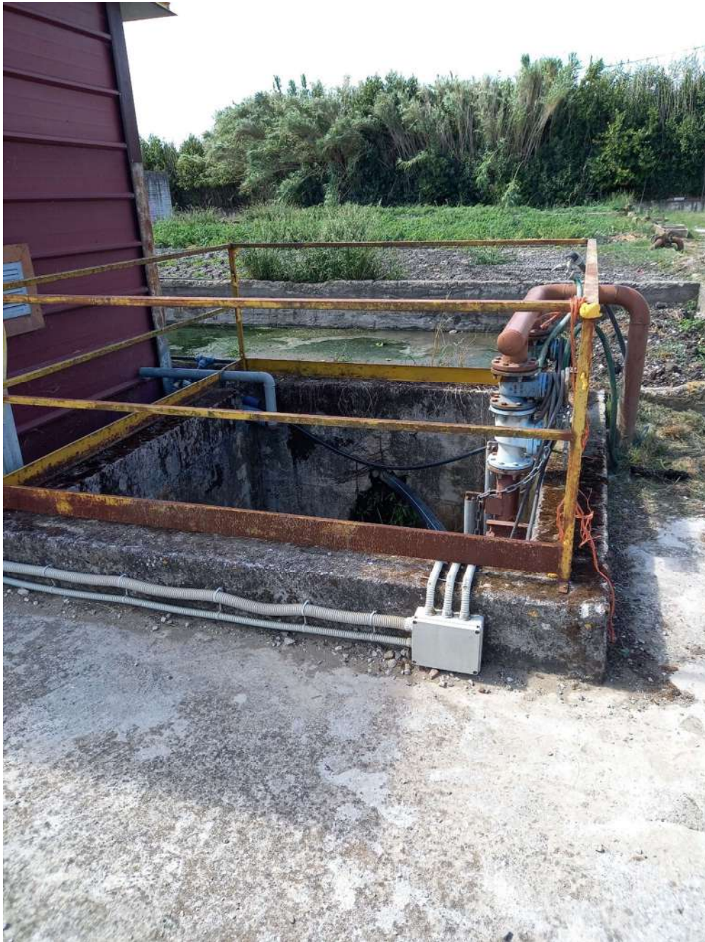
Figura 48: 7 - Pozzetto di accumulo e rilancio dreni
