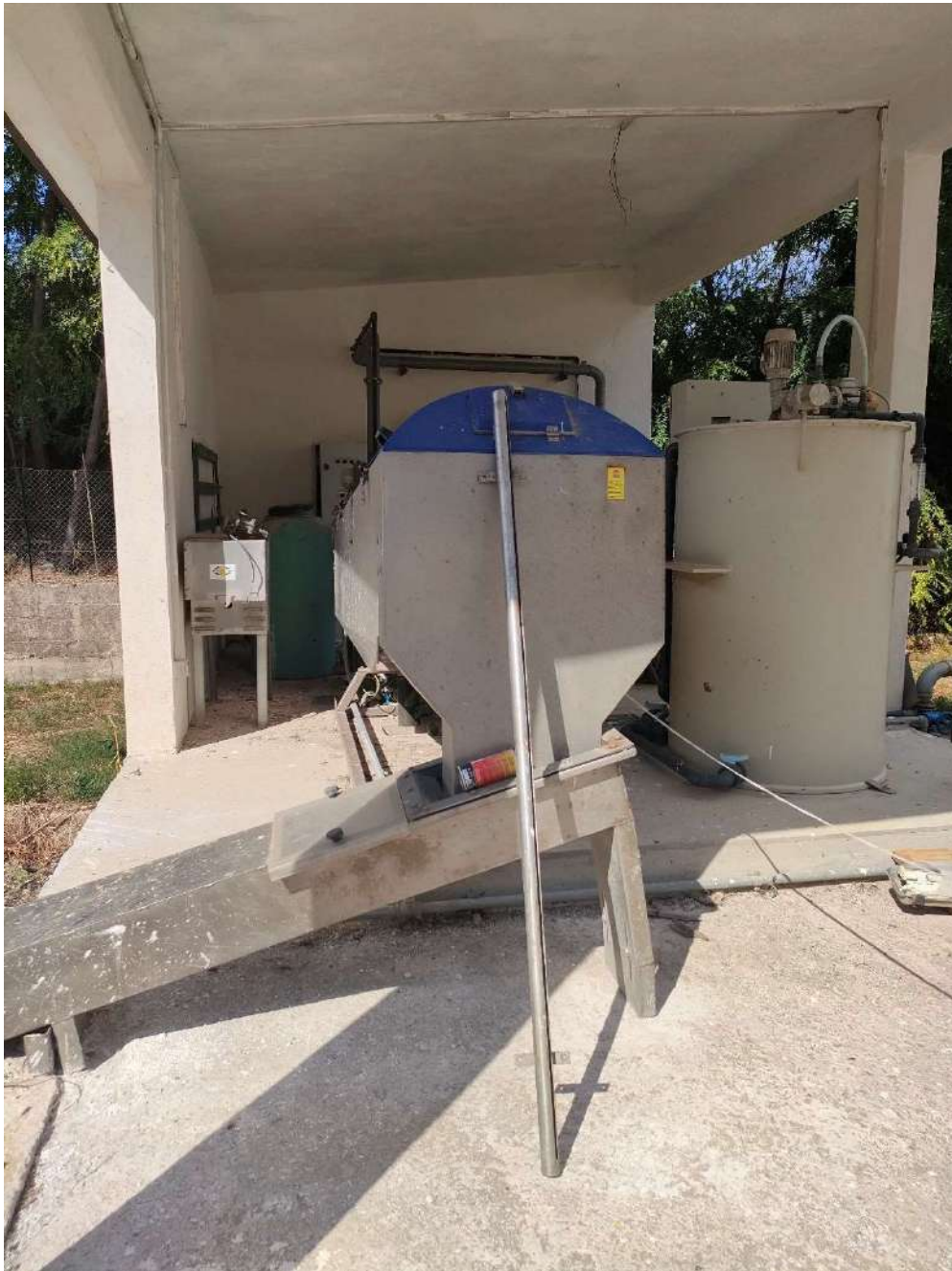
Figura 36: 2 – Centrifuga fuori servizio
