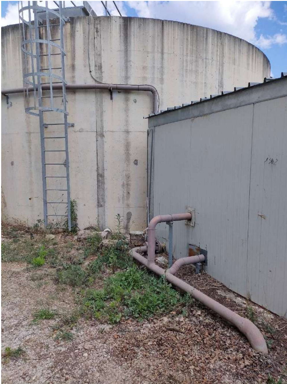
Figura 21: 3 – Ispessitore statico e mandate a locale disidratazione (dismesso)
