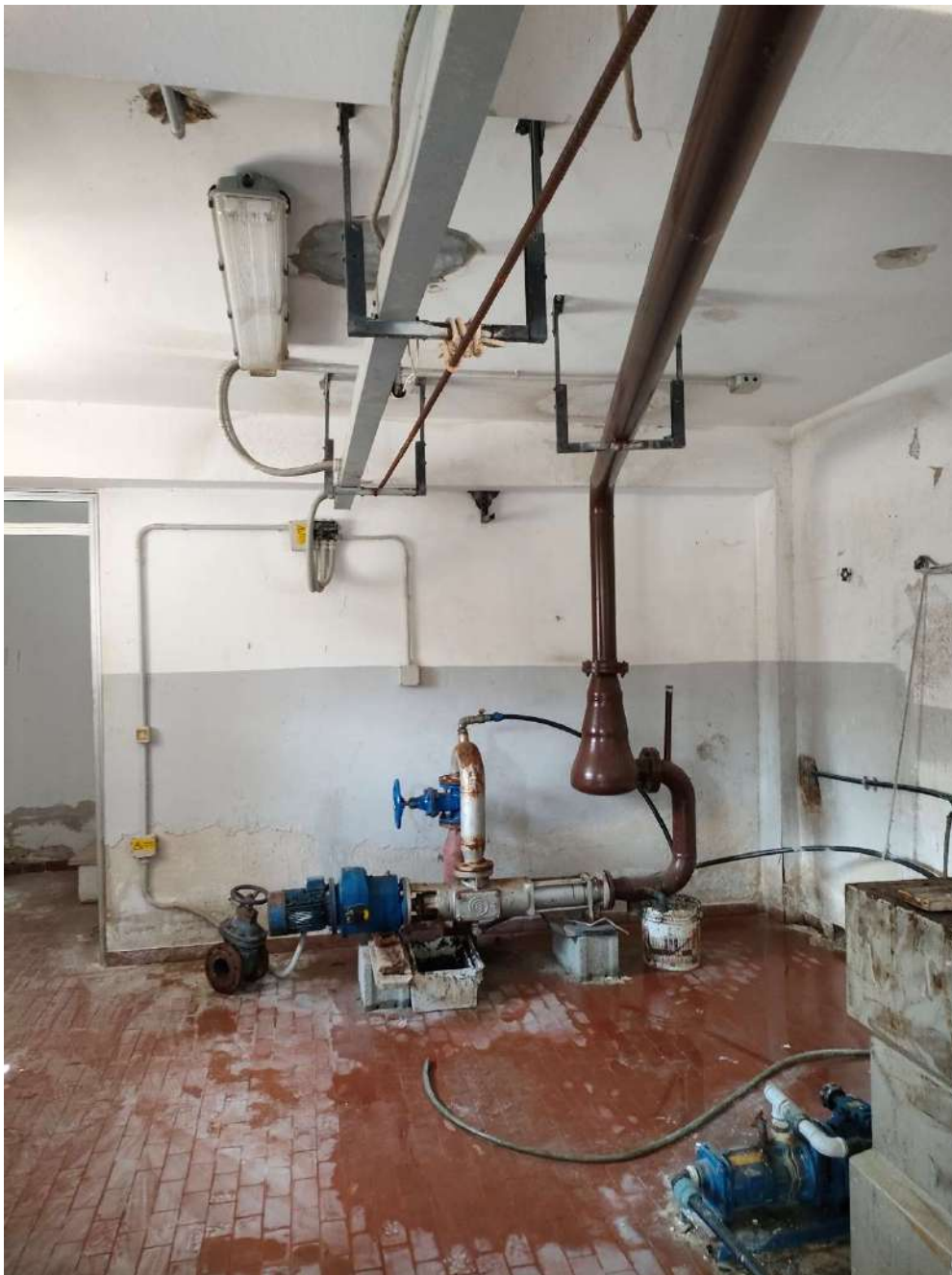
Figura 50: 1 – Piano terra - Pompa alimentazione fanghi a centrifuga
