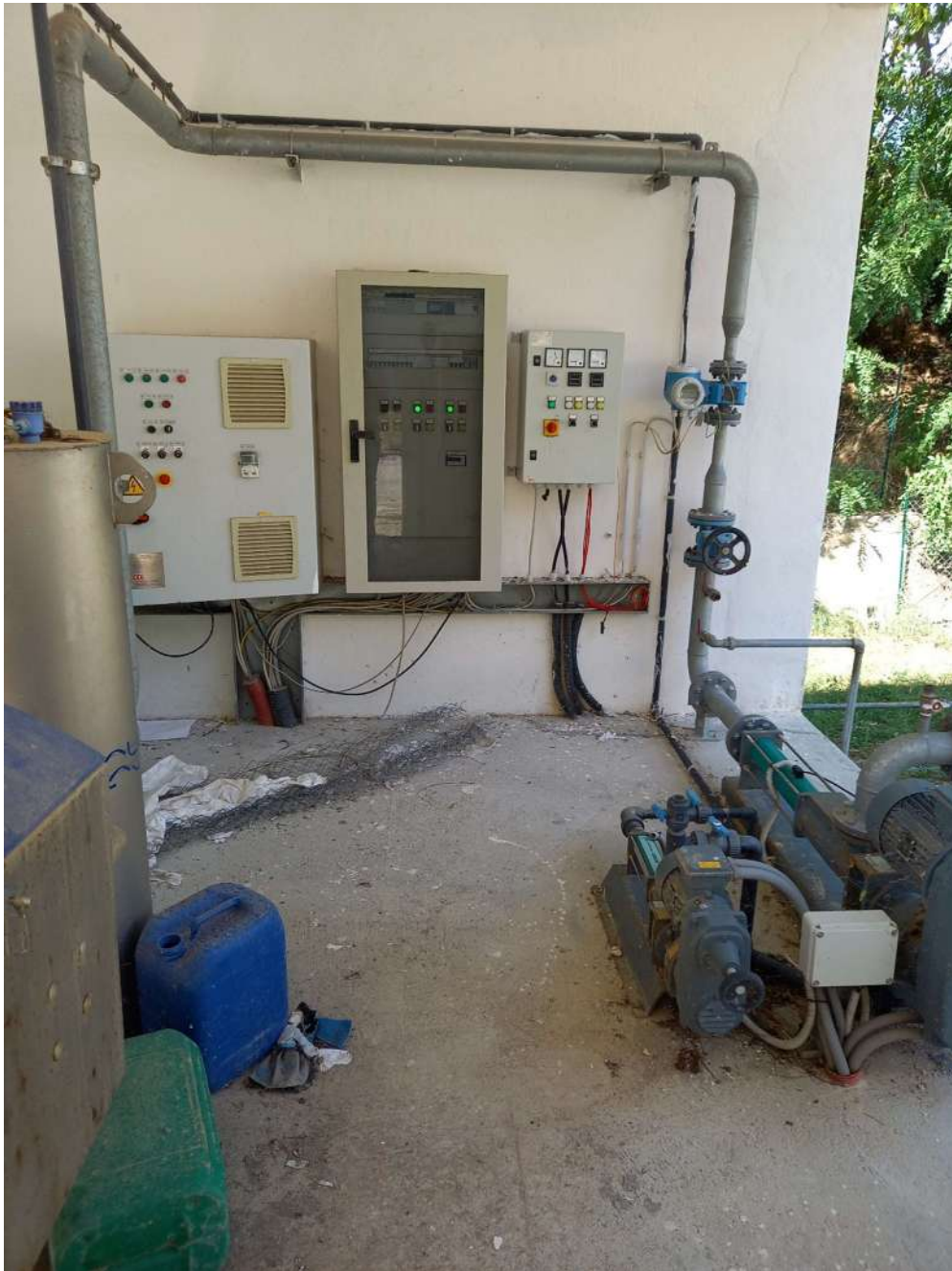
Figura 40: 6 – Quadri elettrici disidratazione
