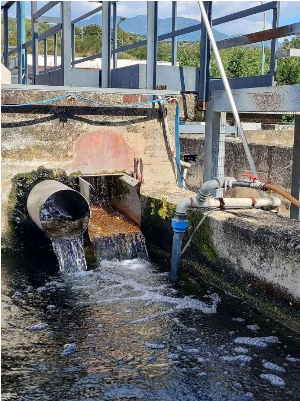
Figura 6: 5 – Prelievo acqua tecnica da disinfezione
