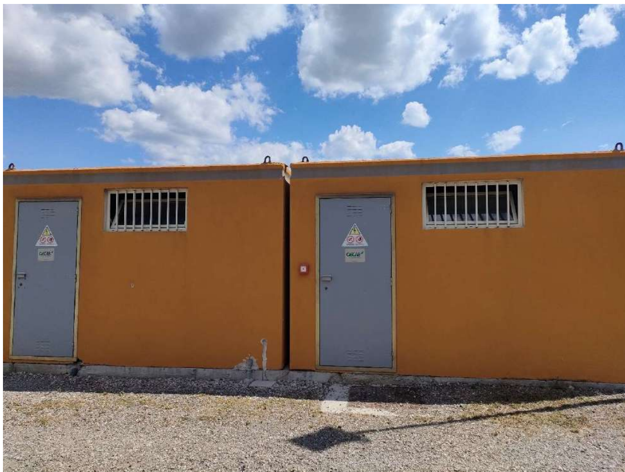
Figura 24: 6 – Locali quadri elettrici
