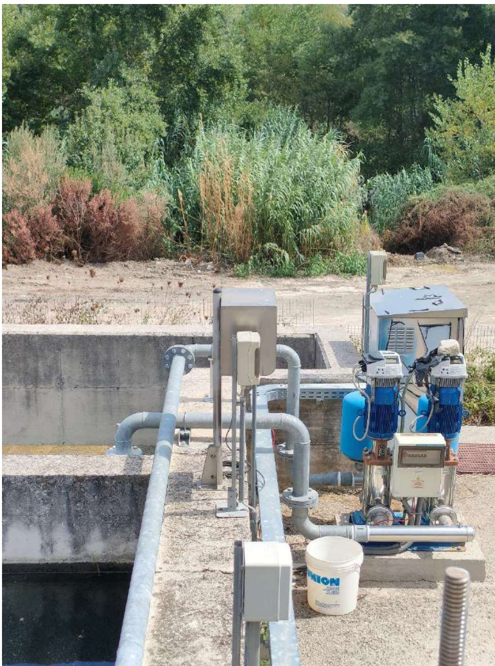
Figura 22: 4 – Gruppo di pressurizzazione con aspirazione e inverter non funzionanti
