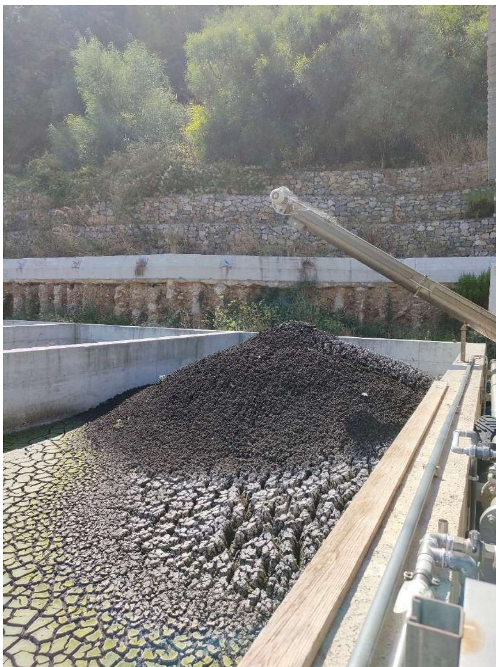
Figura 31: 4 – Letti di essiccamento fanghi
