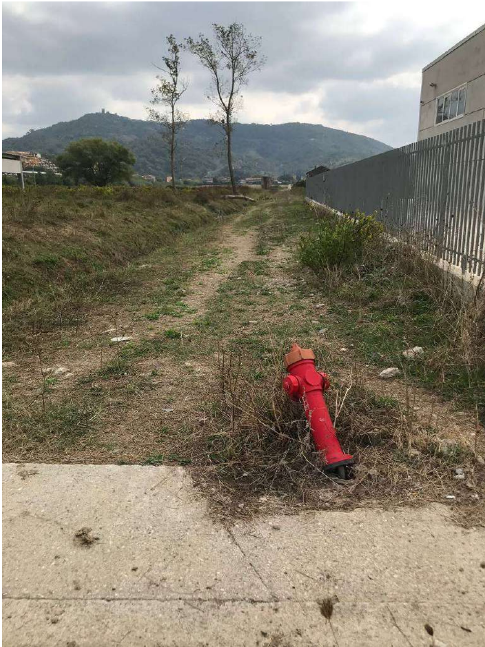
Figura 59: 4- Idrante e canale
