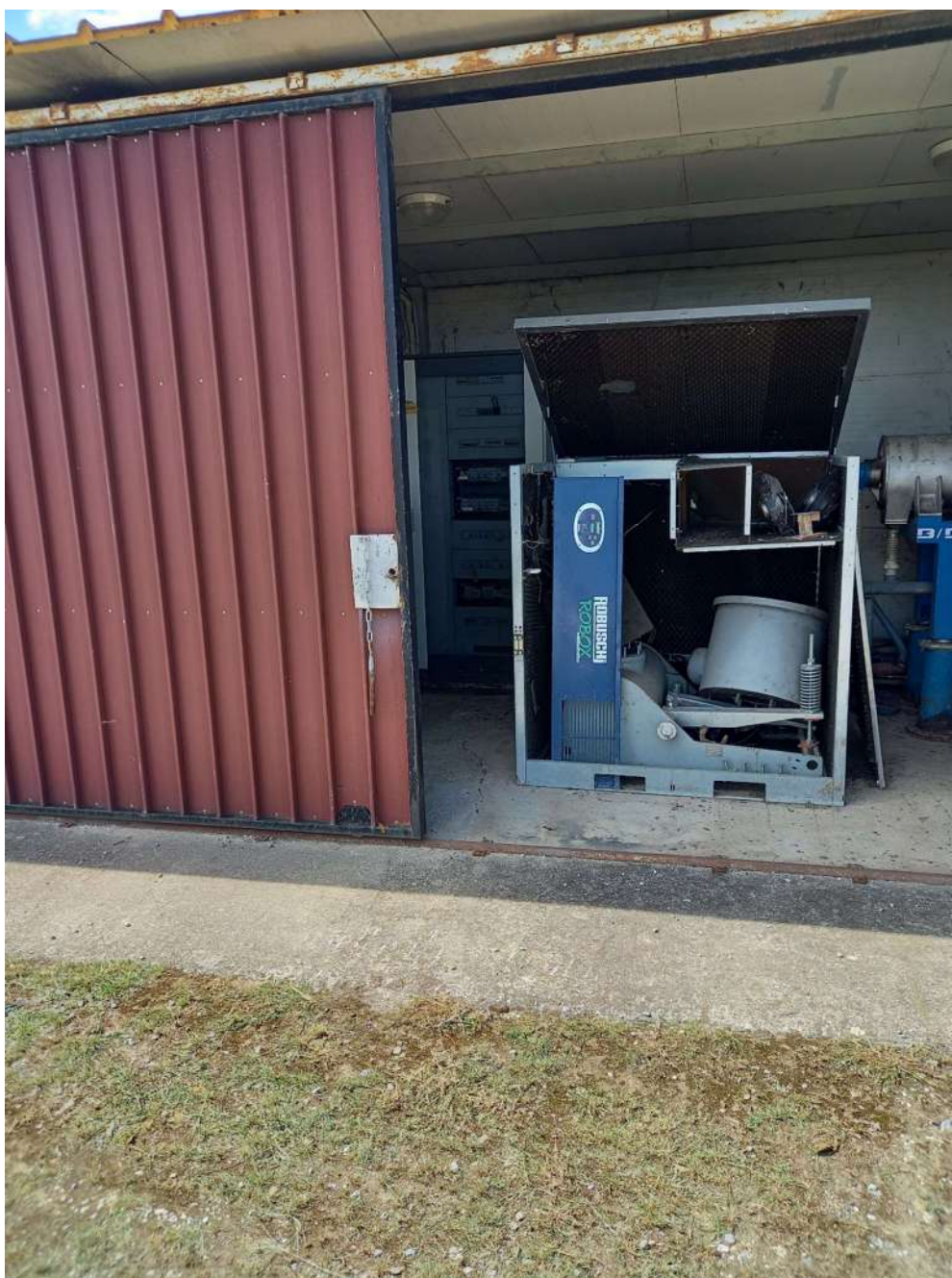
Figura 43: 2 – Locale disidratazione e soffiante dismessa
