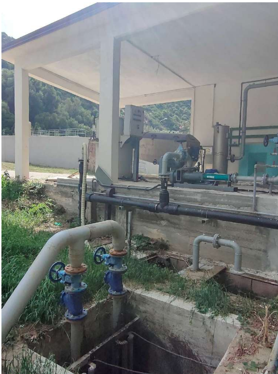
Figura 35: 1 – Pozzetto accumulo e rilancio dreni, surmatanti e acque madri
