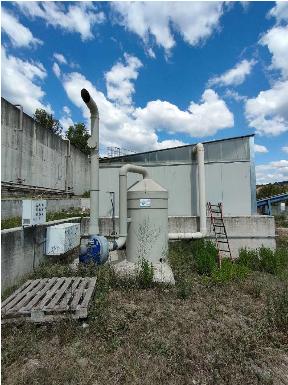
Figura 26: 8 – Scrubber locale disidratazione
