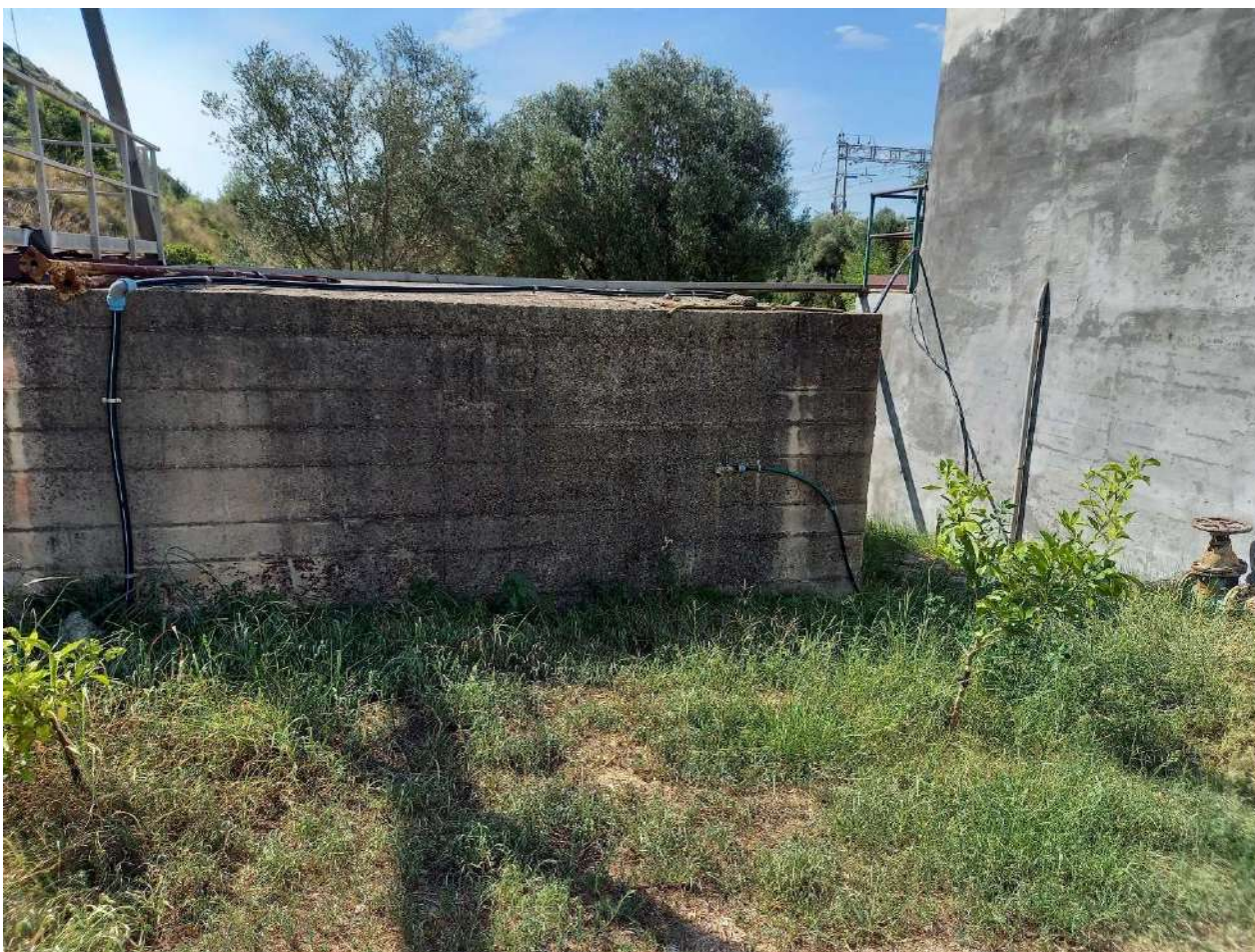
Figura 39: 5 – Stacco acqua tecnica
