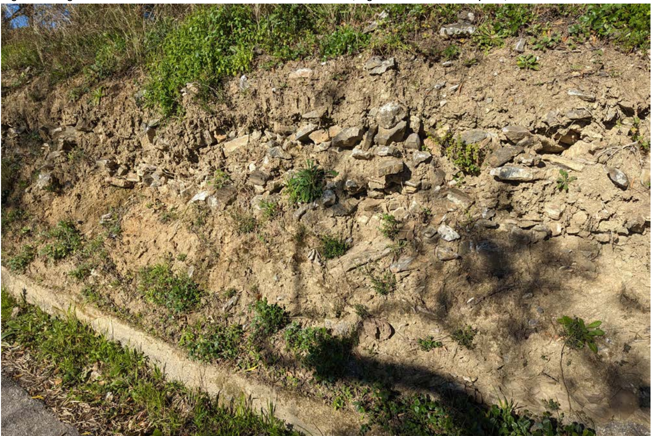
Figura 14 Fascia di alterazione e coperture delle Argilliti di Genesisio (Caprioli)
