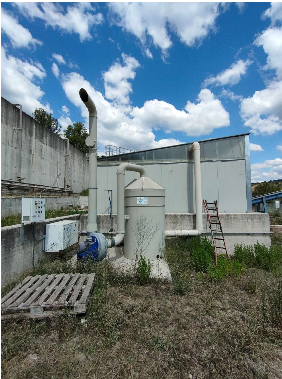
Figura 26: 8 – Scrubber locale disidratazione
