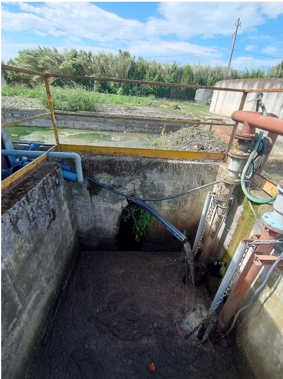
Figura 45: 4 – Pozzetto di accumulo e rilancio dreni
