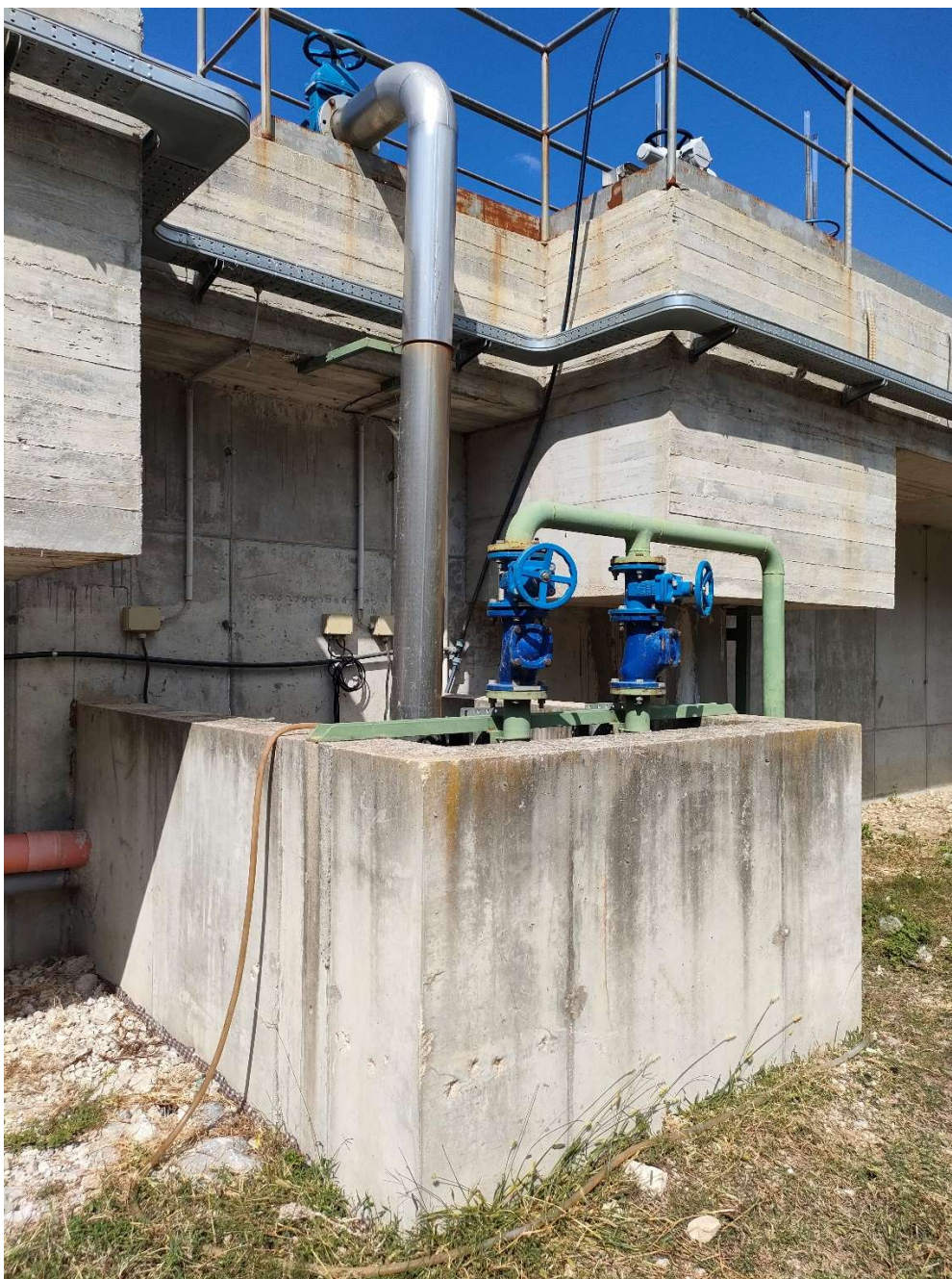
Figura 17: 4 – Pozzetto fanghi di supero
