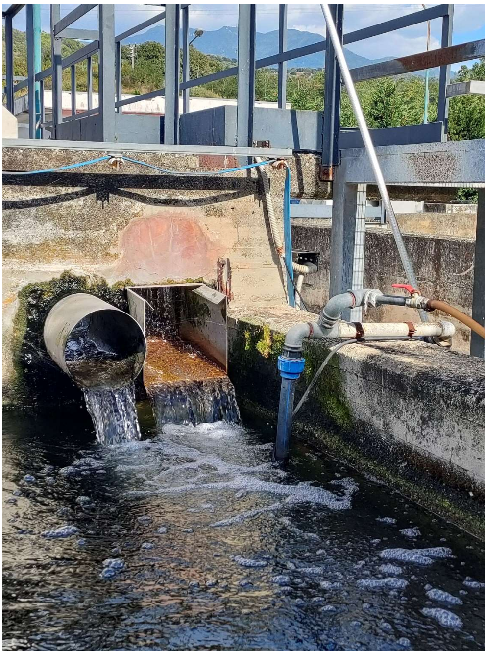
Figura 6: 5 – Prelievo acqua tecnica da disinfezione
