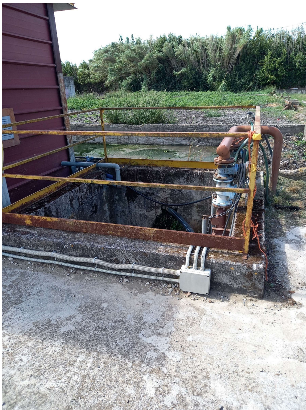
Figura 48: 7 - Pozzetto di accumulo e rilancio dreni
