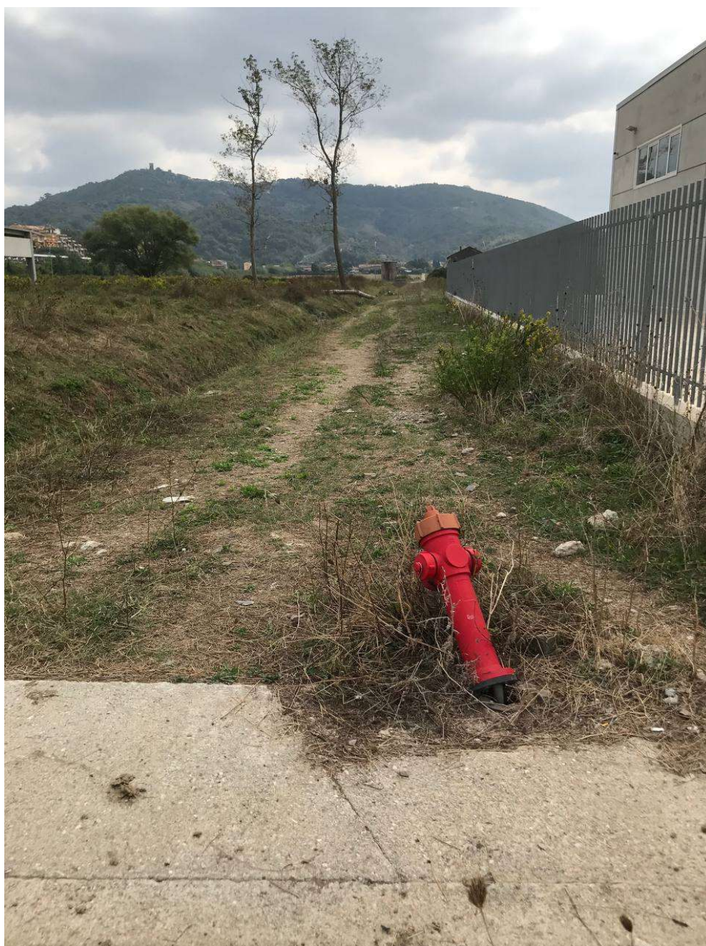
Figura 59: 4- Idrante e canale
