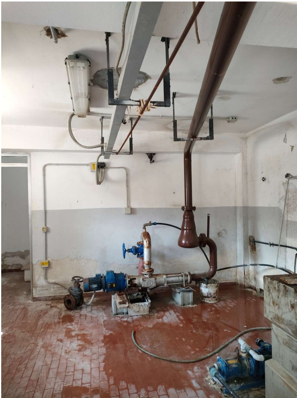
Figura 50: 1 – Piano terra - Pompa alimentazione fanghi a centrifuga
