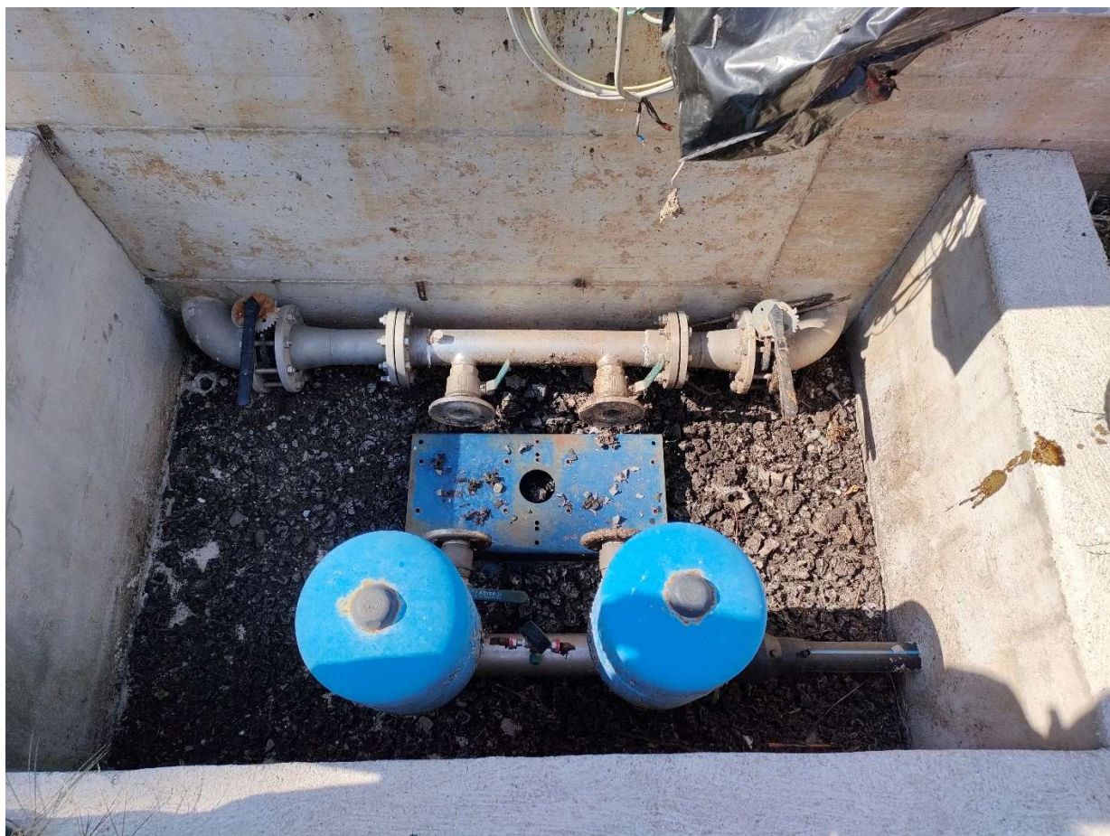
Figura 28: 1 – Predisposizione gruppo di pressurizzazione
