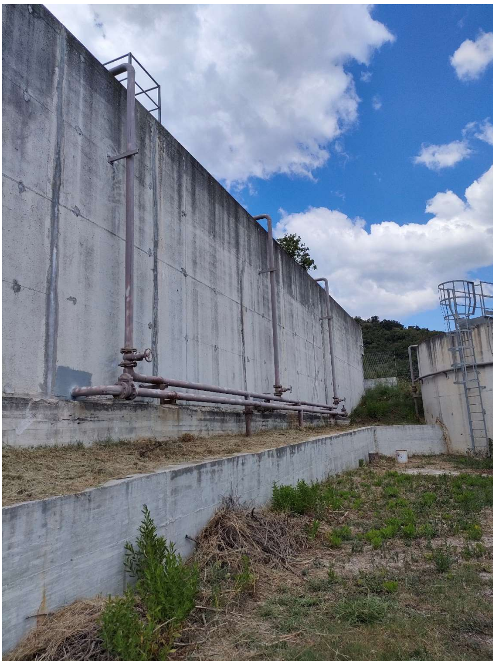
Figura 20: 2 – Comparto di digestione aerobica
