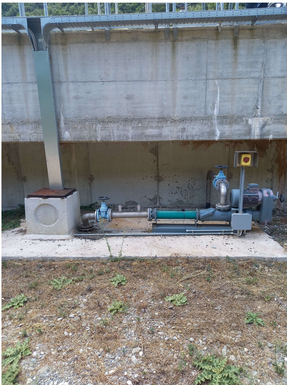
Figura 30: 3 – Pompa di alimentazione fanghi alla centrifuga
