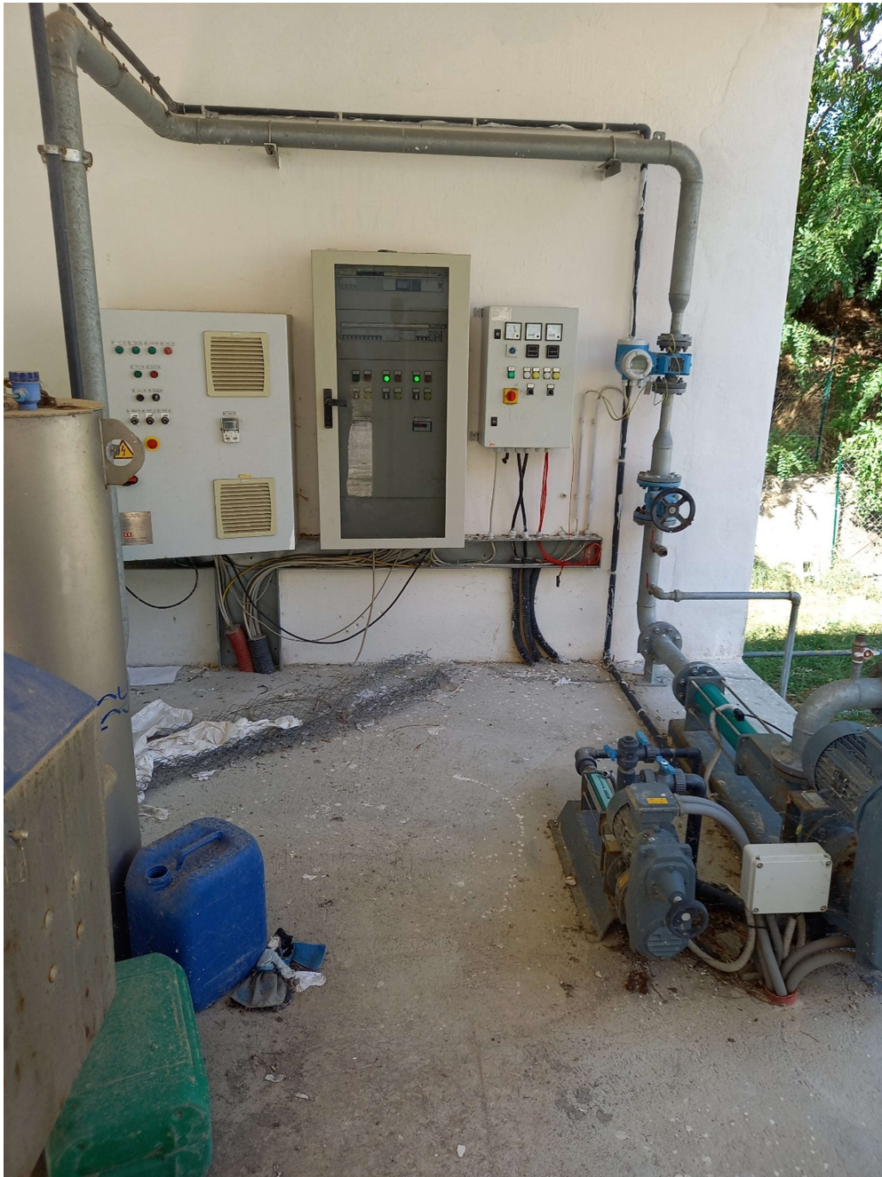
Figura 40: 6 – Quadri elettrici disidratazione
