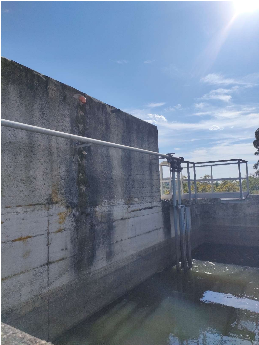
Figura 2: 1 – Sollevamento digestione aerobica
