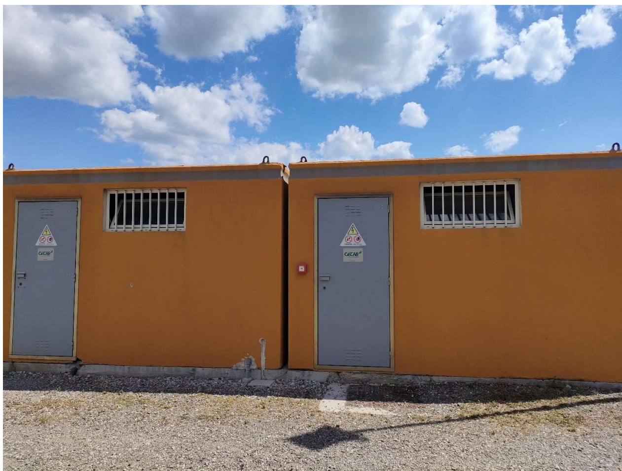
Figura 24: 6 – Locali quadri elettrici
