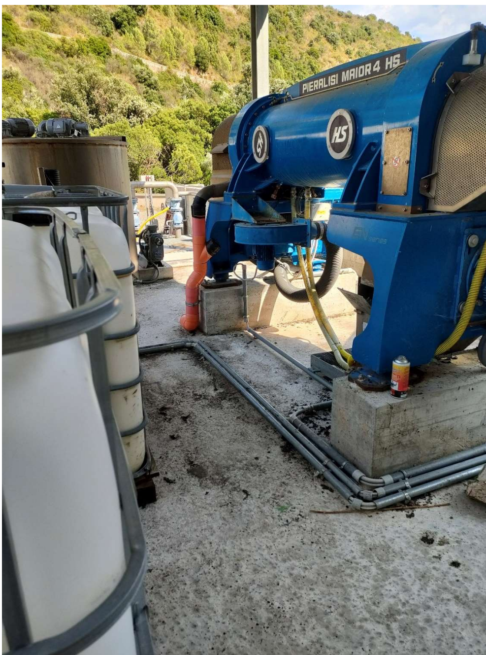
Figura 29: 2 – Centrifuga per disidratazione fanghi
