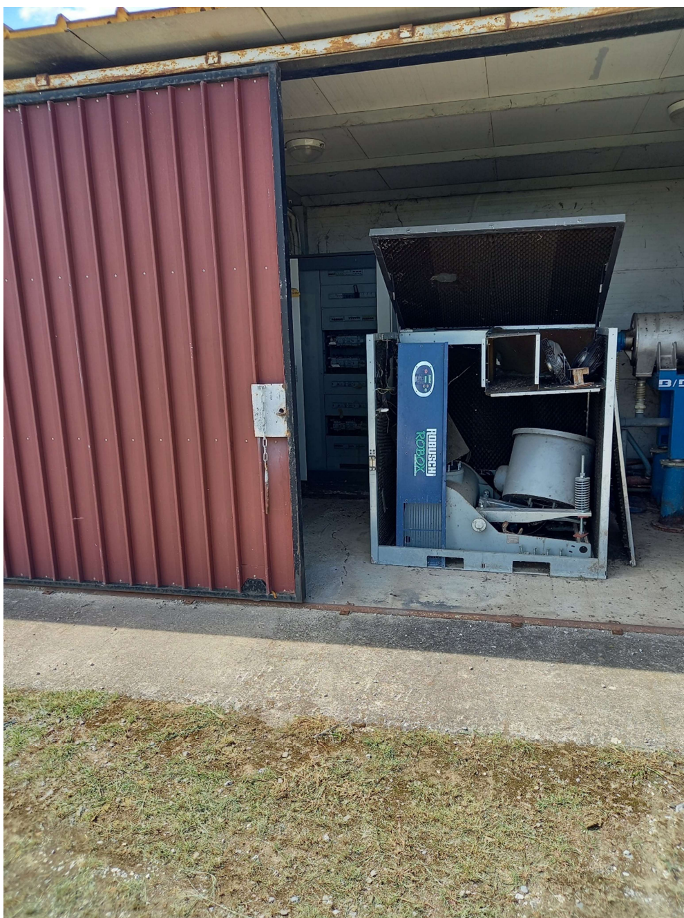
Figura 43: 2 – Locale disidratazione e soffiante dismessa
