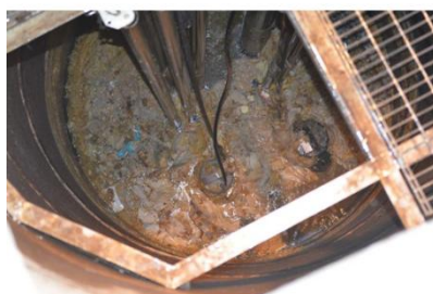
Prima dell'installazione di Concertor
