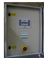
[quadro elettrico - immagine tipo]
